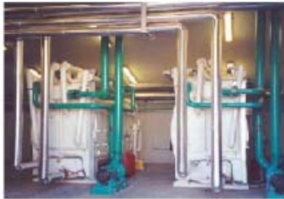
圖9 吸附式冰水機 350 KW 兩台〔11〕
